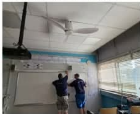
Au premier étage de l'école du Pra d'Estant, Léandre et Éric s'affairent aux derniers réglages. Au-dessus d'eux, l'un des quatre brasseurs d'air posé dans cette classe. PHOTO ROMAIN HUGUES
